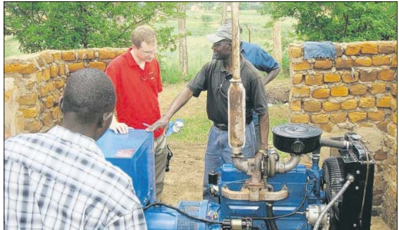
Der neue Generator sorgt für eine sichere Stromversorgung in der Großbäckerei von Arua. Der Energiekonzern RWE hatte den Generator spendiert, der vom Ugandakreis per Container nach Afrika verschifft wurde.
